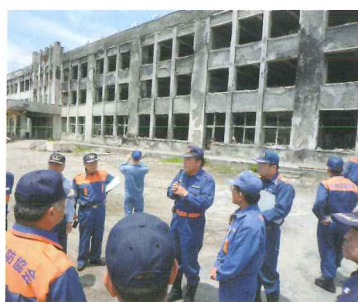
津波による損壊、その後の火災により 燃え尽くされた門脇小学校（石巻市）
